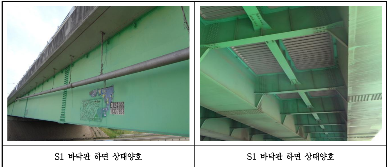
【사진 2.3.3】 바닥판하면 손상현황
